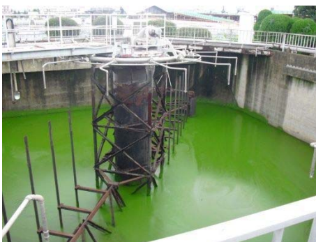
(ホ) 重力式汚泥濃縮タンク
