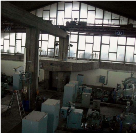
(ロ) 第1ポンプ場 (揚水ポンプ)
