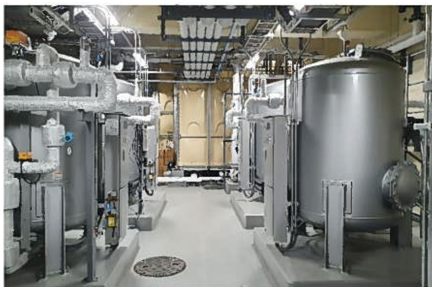
地下水処理設備（新水産棟）
