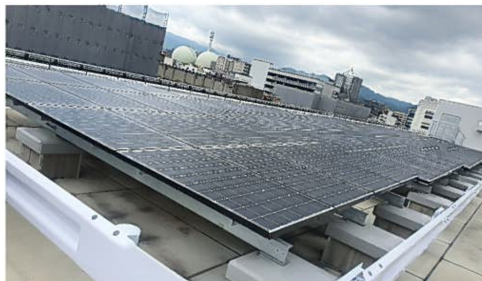
太陽光発電パネル（新水産棟）
