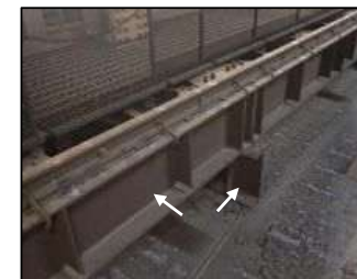
⑦ ごみクレーン支持梁【建物】 焼損跡があり、火害調査（→部）にて補修方法を確認する。
