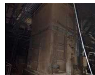
⑥ 弾性ごみ切断機【設備】 煙と熱の影響で切断機全体が 焼損している。
