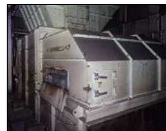
⑤ 破砕物搬送コンベア【設備】 コンベアの内部全体が焼けて いる。
