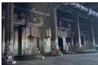
① プラットホーム【建物/設備】 壁の防音材のほか、電動シャッター、照明などの電気設備（盤、ケーブル等）、消防設備等の多くの設備が焼損している。 ※ ②、③等（粗大ゴミピット周辺）も同様
