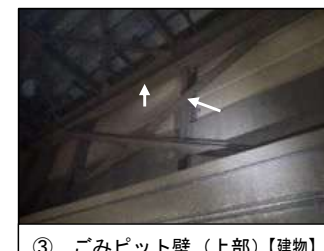
③ ごみピット壁（上部）【建物】 壁面に亀裂が多数発生している。梁等（一部）は火害調査にて補修方法を確認する。
