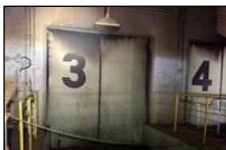
② 投入扉【設備】 扉や駆動装置が焼損している。
