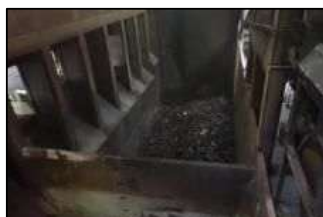
③ 粗大ごみピット【建物】 コンクリートの火害調査にて補修方法を確認する。焼け残った粗大ごみを除去する必要がある。
