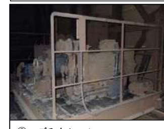
⑧ ごみクレーン（上部の駆動機） 電動機や電気ケーブルなど全体が焼損している。（駆動機を支持する桁部分は概ね健全）
