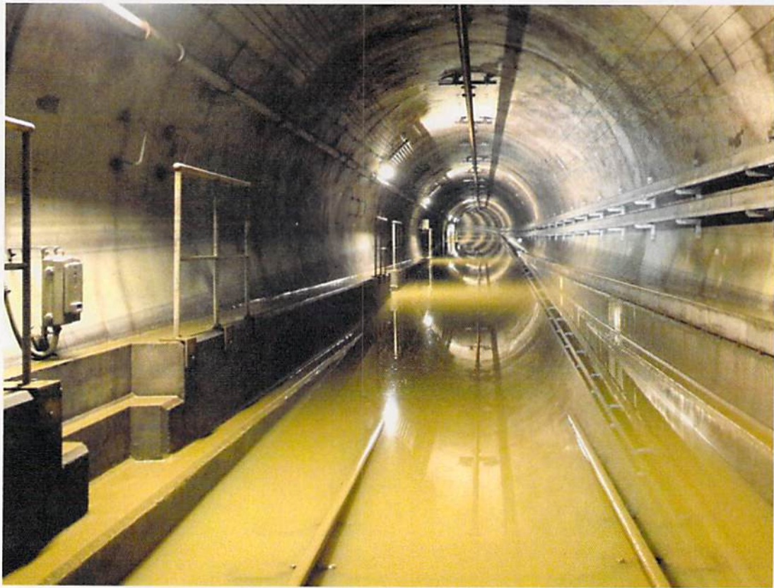
水没した御陵～山科駅間のトンネル (撮影：9月18日夕方)
